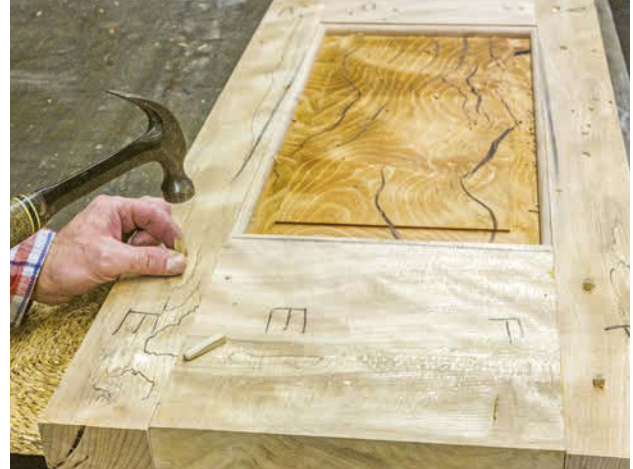
Schritt 26: Treiben Sie die Holznägel mit einem Hammer ein. Arbeiten Sie zügig, damit die Nägel nicht auf halber Strecke stecken bleiben.
