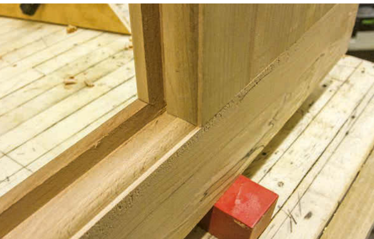
Schritt 19: Stecken Sie jede Verbindung einzeln zusammen, und setzen Sie Zwingen an, um einen Eindruck davon zu bekommen, wie die Passung bei der fertigen Tür ausfallen wird.
