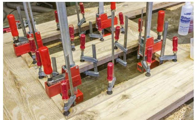
Schritt 16: Leimen Sie den Rahmen aus Füllungsstäben mit einem flexiblen, fugenfüllenden Klebstoff (z.B. Epoxidklebstoff).
