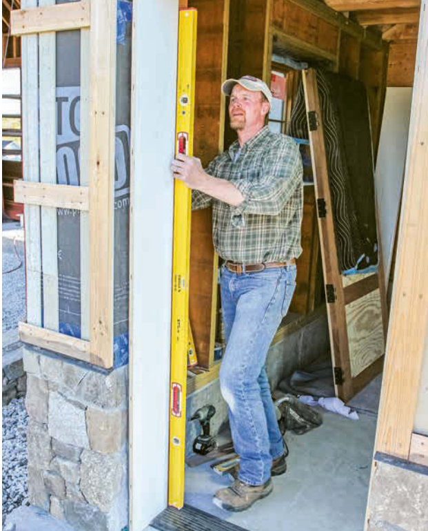
Zuerst wird die Zarge für die Bandseite der Tür angebracht. Mit einer langen Wasserwaage wird sie lotrecht ausgerichtet.
